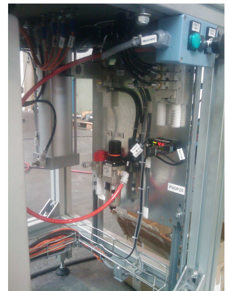
Imagen 4:Neumatica de la instalación
